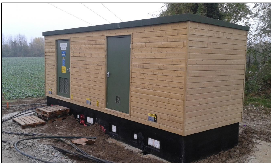
Figure 22 : Poste de livraison du parc éolien de Leury, commune de Crouy.
